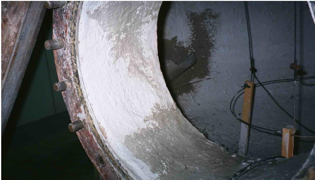
Fig. 3 Acumulador existente con protección catódica según UNE-EN 12499
