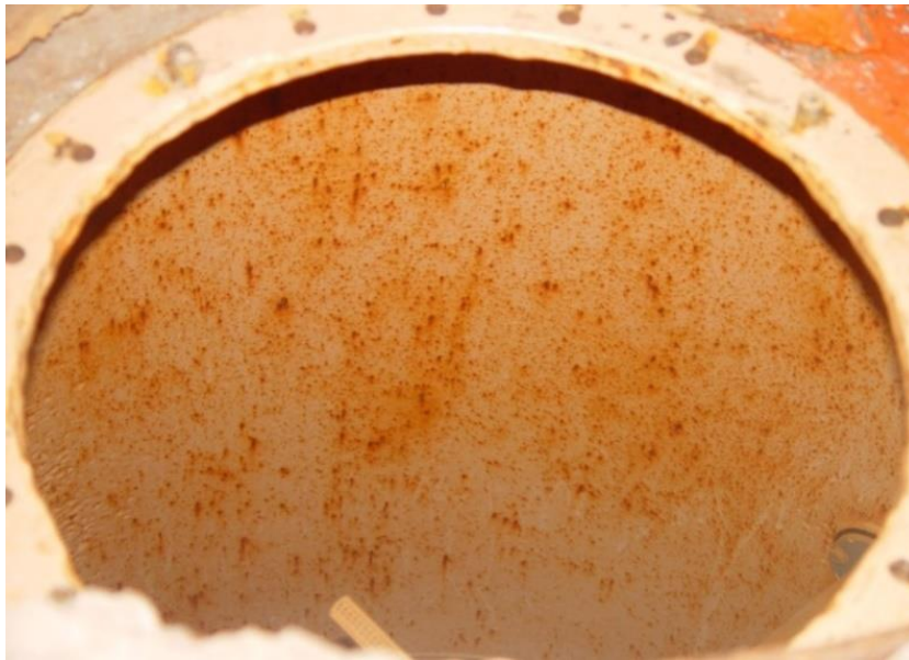
Fig. 2 Aspecto de un acumulador a los dos años de su repintado
