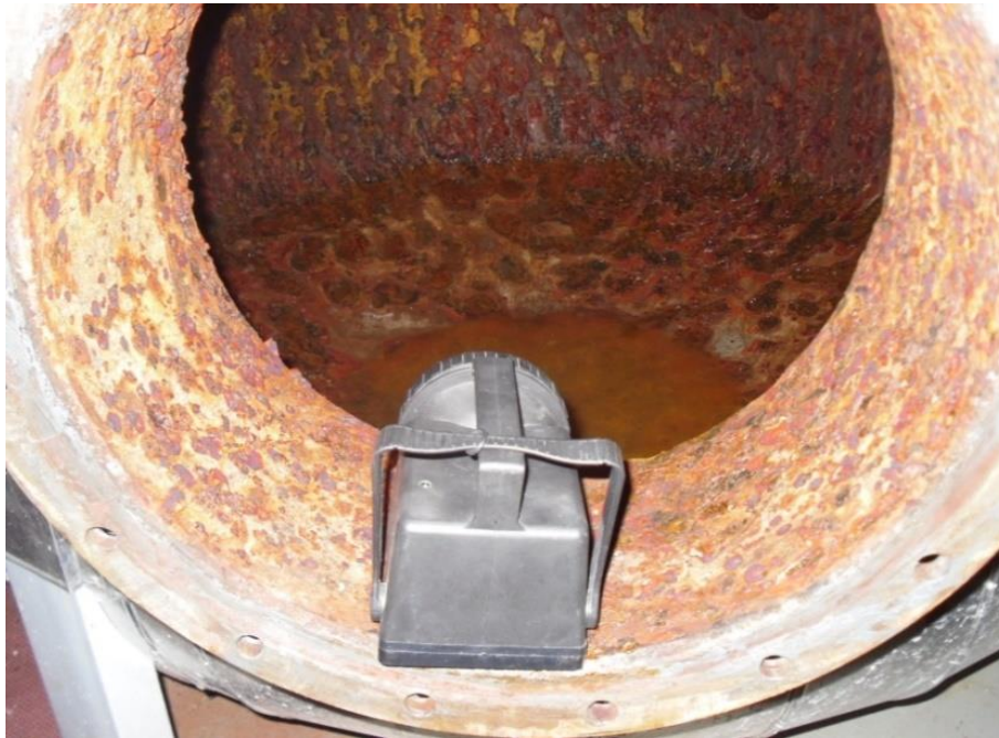
Fig. 1 Aspecto interior de un acumulador corroído
